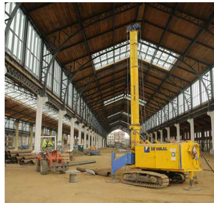
In elk project is de tonnageberekening uit de stabiliteitsstudie het uitgangspunt voor de berekening van de paalfundering.
